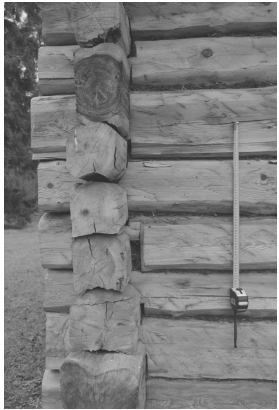
Foto 2.6.8 Nurk DE. Asenduspalkide vigased õnarused ja kaelad
