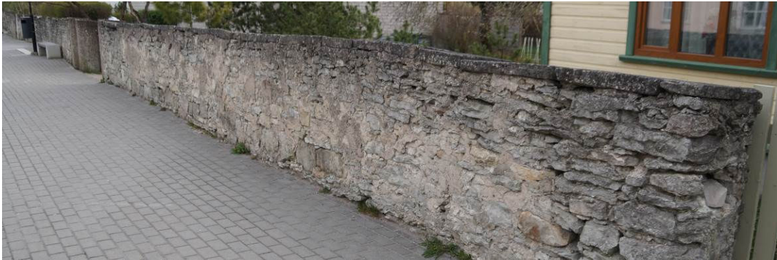
Foto 4 Pikk tn 44a ees on kiviaed õhukese, kuid aja jooksul osaliselt koorunud krohviga kaetud.
