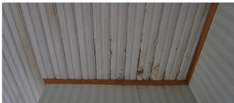
Illustratsioon 17. Kahjustunud laelauad korstna kõrval; foto asukohast 11
