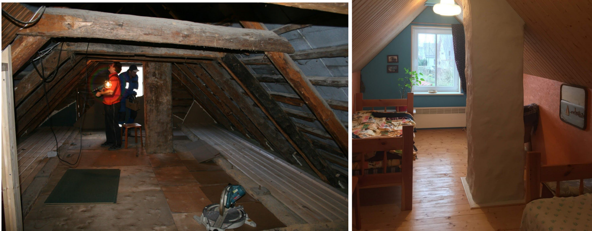
27, 28. Pööningu põhjapoolne osa renoveerimise ajal ja valmiskujul. Fotod: Peeter Jalakas ja Gerda Ruuser.
