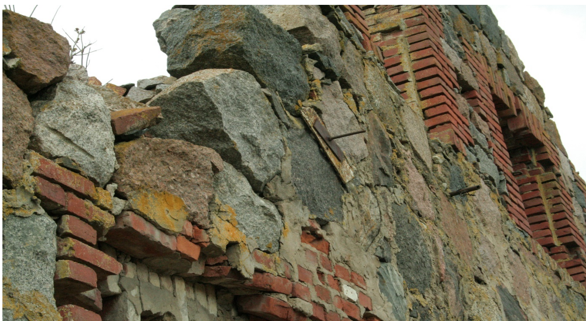
Foto 23. Avaused lõuna poolses seinas
