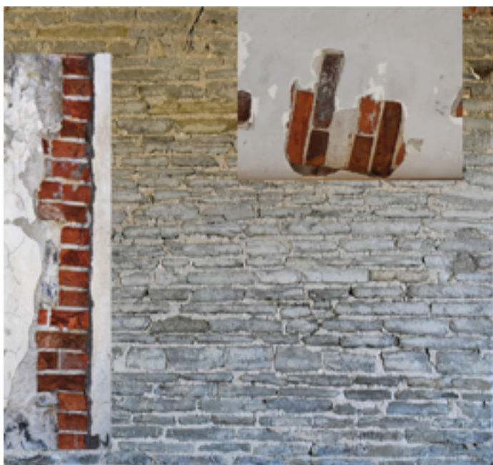
40. Autori kollaaž. Fragment paekivist vaheseinast. Fragment punase tellise puhtast vuugist 1 ruumi aknaavas.
