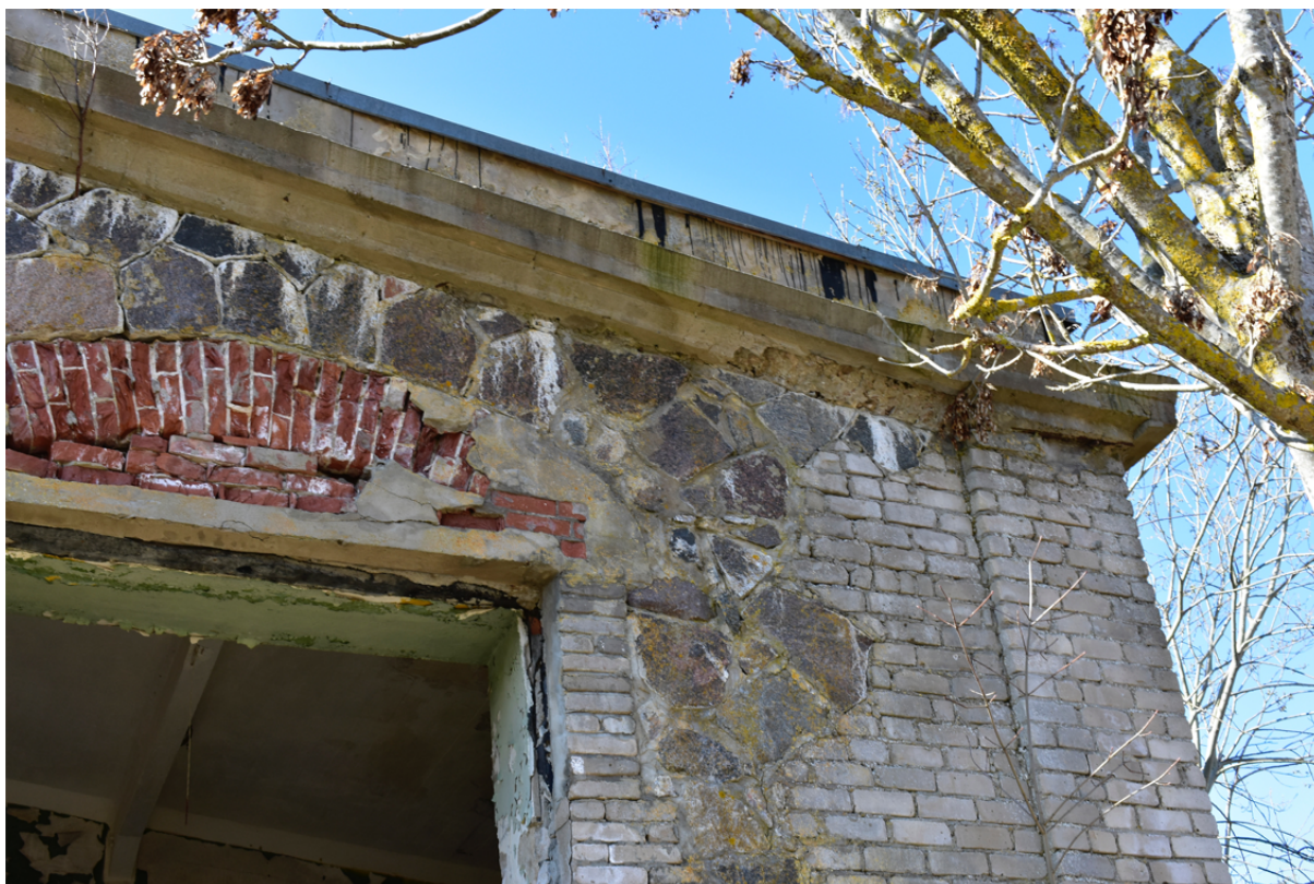
52. Hoone otsafassaadi katusetarindil on näha nii tõrvajäled kui ka plekk. Autori foto
