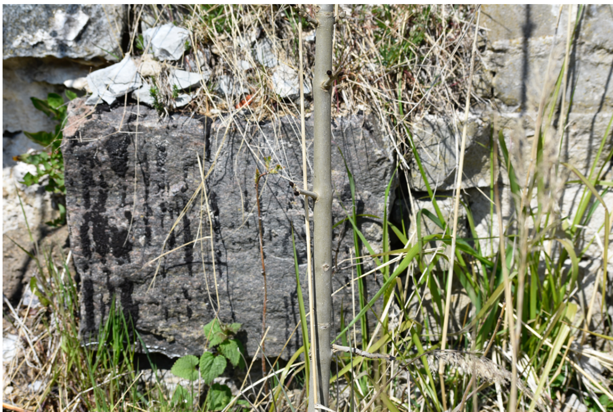
53. Tõrvajäljed hoone otsafassadi soklikivil. Autori foto
