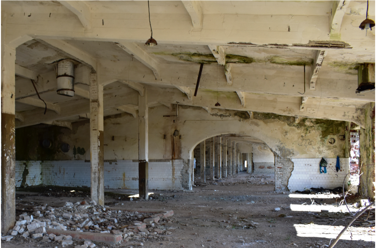
55. Niiskuskahjustused ruumis 1, seintel ja laes. Autori foto
