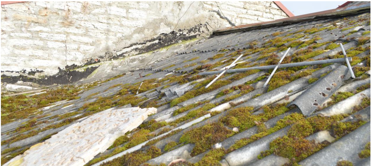
Illustratsioon 9. Lagunevad eterniitplaadid.
