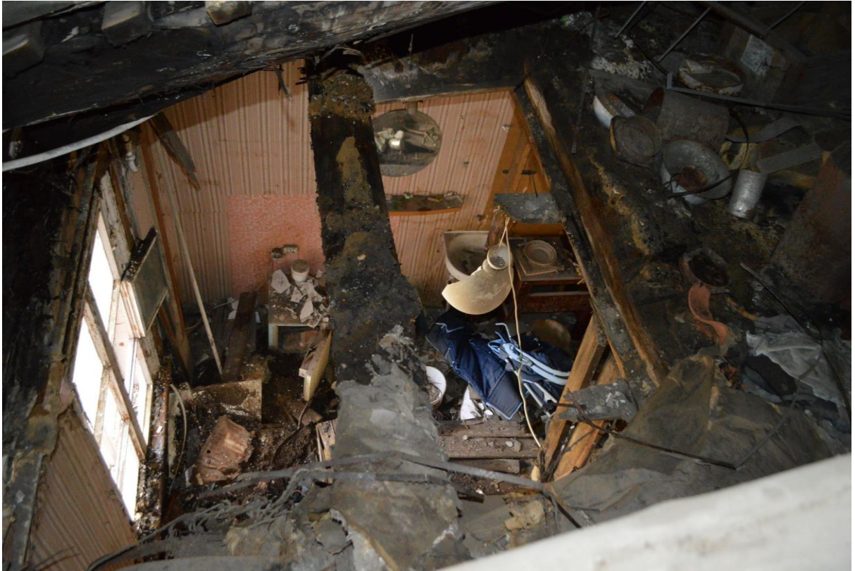
Illustratsioon 39. Vaade teise korruse köögi sisse vajunud laele pööningult.
