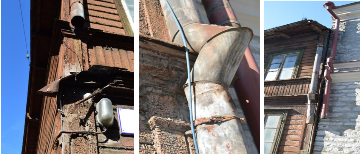
Illustratsioonid 17, 18, 19. Puuduvad ja lagunened vihmaveetorud.
