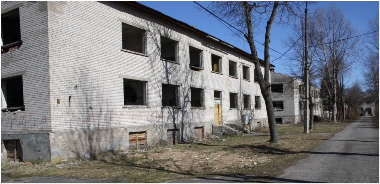
22. 1950. aastate lõpul ja 1960. aastate alguses hoonestatud Sirgalas on suur osa kortermajadest hüljatud. Sirgala jäigi lõpuni ehitamata.
