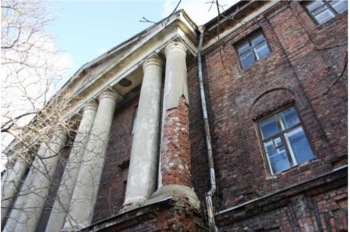
Illustratsioon 47. Lagunenud sambad ja seinad keskrisaliidil.
