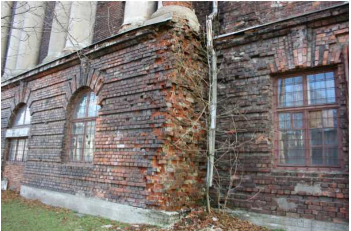
Illustratsioon 48. Lagunenud sambad ja seinad keskrisaliidil.
