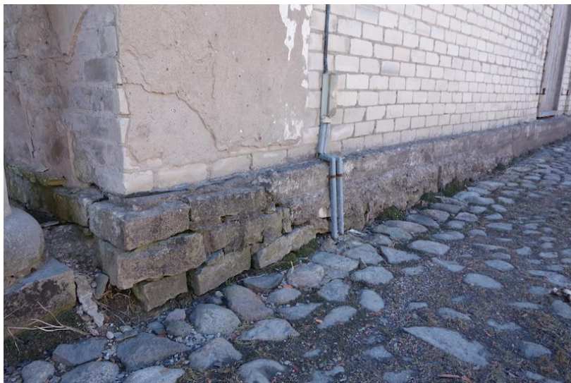
Foto 4: -Talupoegade talli nurgas on säilinud paekivist sokkel kus on täheldada vajumist.
