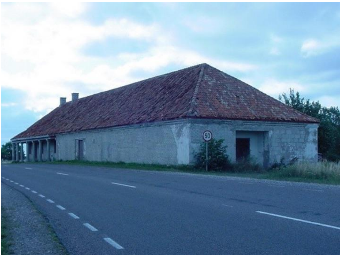
Foto: Kuivastu kõrtsihoone aastal 2003, kus on näha lagunevat katusekatet. Autor, Jaan Väli, Muinsuskaitseameti Jaan Väli fotokogu, https://register.muinas.ee/public.php?menuID=photolibrary-collection-785&filter%5Bcollectiontype%5D=785&page=132&lang=en ,
