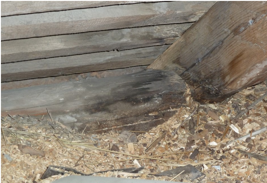
Foto nr. 8. Sadevee kahjustusi saanud räästapärline ning sarika tapikoht
