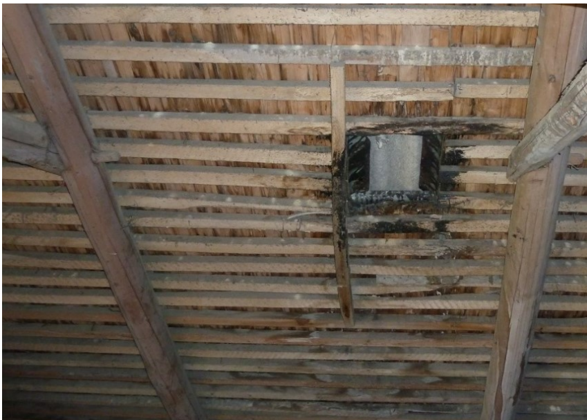
Foto nr. 19. Ruumi nr. 9 kohal katuse roovitises olev vana korstnatoru läbiviiguava.
