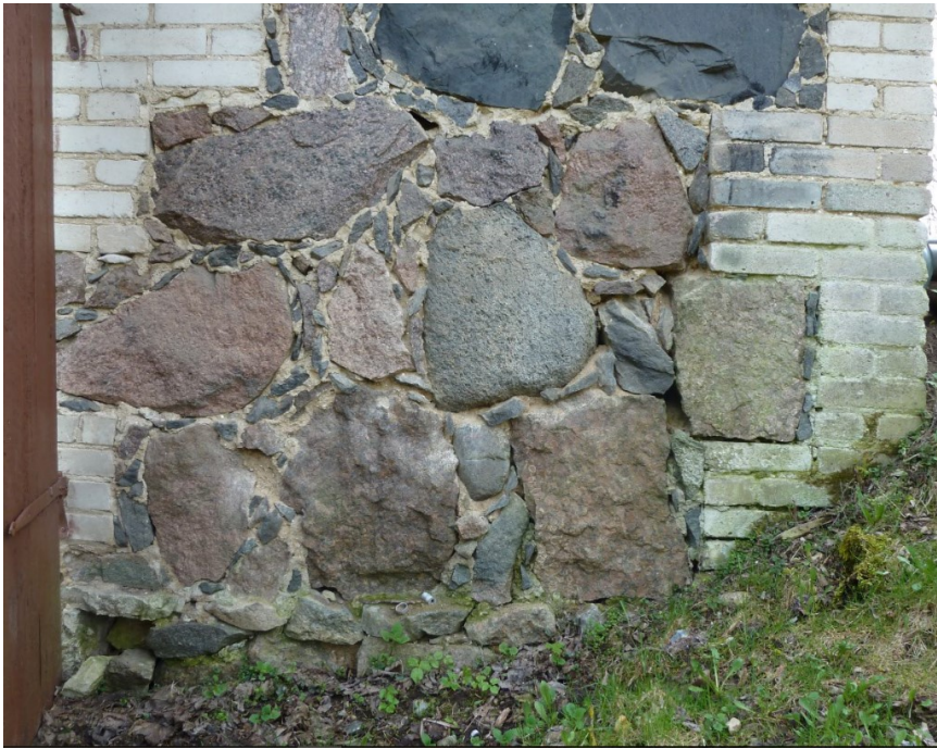
Foto nr. 22. Vaade põhjapoolsele välisseinale. Vasakul all nurgas kivid seinast irdunud. Samuti silikaadist nurgalaotise kõrval on sadevesi segu vuugist uhtnud.
