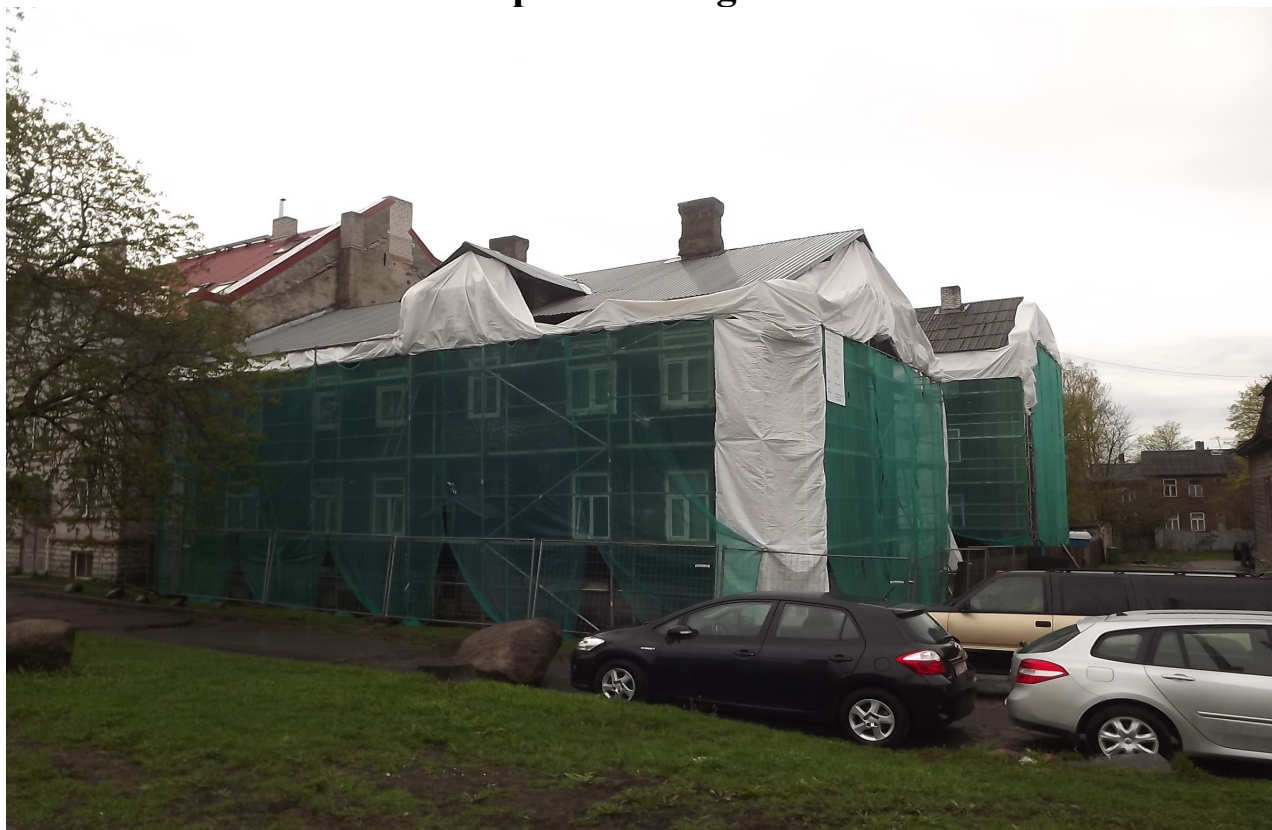
Foto nr. 1 Lubja 9/1 hoone palkkehandi seisukord ei ole just parim kuid siiski piisavalt hea, et seda taastada.
