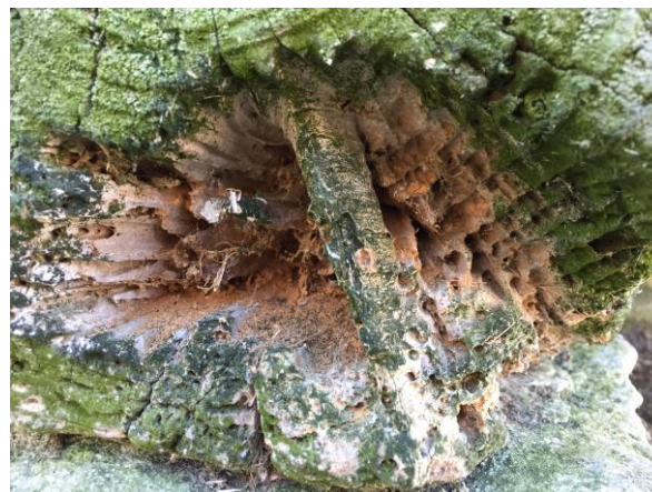
90. Niiskuse ja kahjurite poolt tekitatud kahjustused
