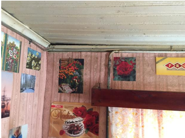
55. Põranda ja seina vajumine avaldab mõju ka lae ja seina liitekohale
