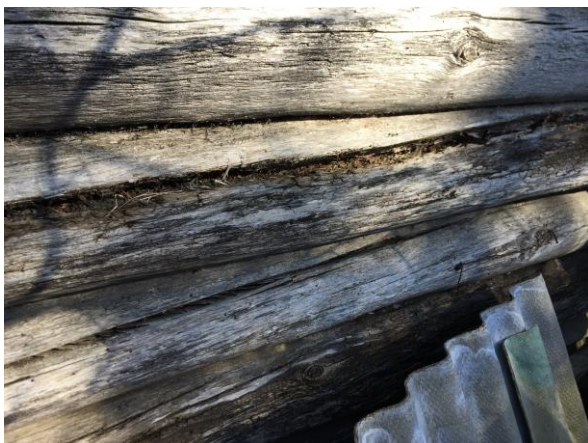
89. Aidahoone kahjustatud välised seinapalgid
