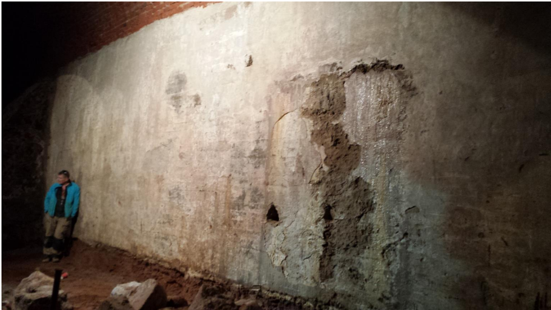
Foto 4. Koht betoonist seinas, kust vesi läbi tungib, ruumis 3.
