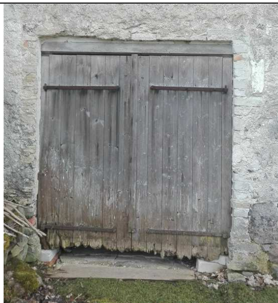
F 44: A2 N-küljel vaheuumi värav: ava suurust on muudetud, kuid krohviraamistuse rant on jälgitav; siseküljel ava servas suur avasse ulatuv maakivi. *Leng ja väravad hilisemad.
