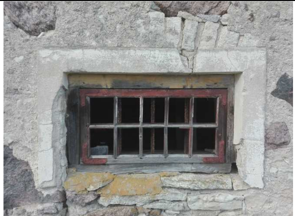
F 32: B osa S-küljel I korruse aken: komplektne – krohviraamistusega ava, leng, raam, nurgikud, kantrauast trellid.
