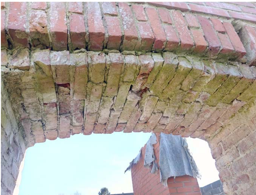
Põhjakülje ukse sillus – murenenud tellised ja vetikas. Foto autor: Mari Renno, 20.04.2017 a.
