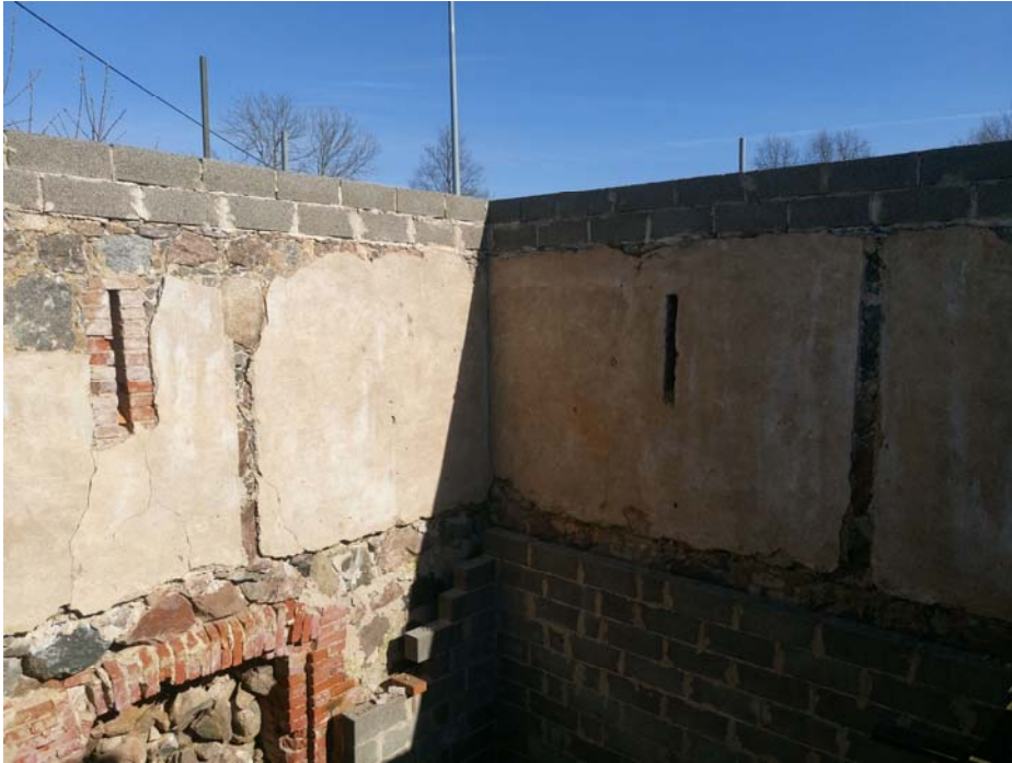
Krohvipinna katkestused viitavad hävinud vaheseintele. Foto autor: Mari Renno, 20.04.2017 a.
