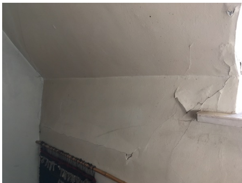
Ill. 40 Läänepoolne välissein teisele korrusele trepi kohal. Praod on tekkinud 2012-2017. a. (autori foto)
