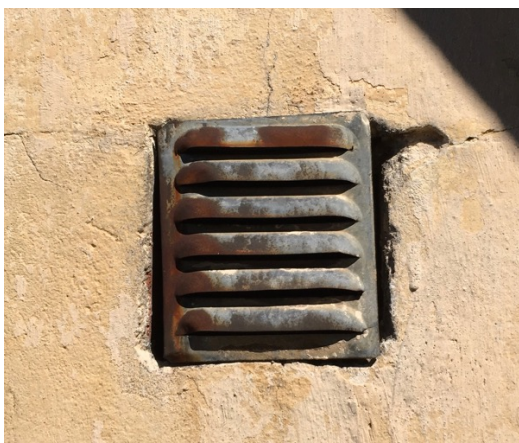
III. 60. Ventilatsioonirest välisfassaadis (autori foto)
