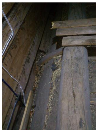
Kiriku katuseremondist jäetud, halvasti koristatud laetarind. Lääneseina keskel.
