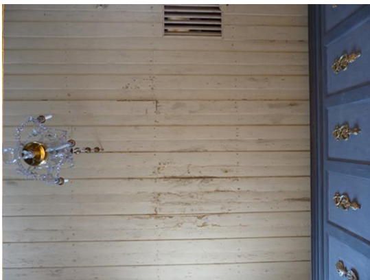
Veekahjustustes määrdunud ja irdunud lubivärviga laeväli.
