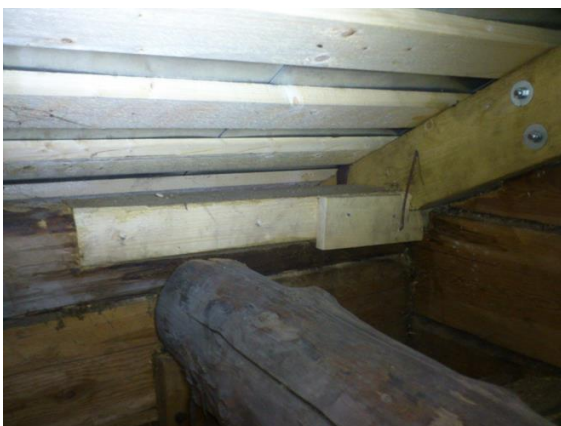
Probleemne väljavajunud põhjaseina tarind.
