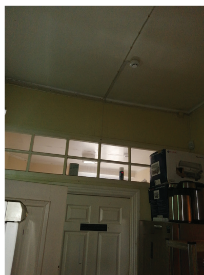
Allatoodud lagi I korruse vahekoridoris (48)
