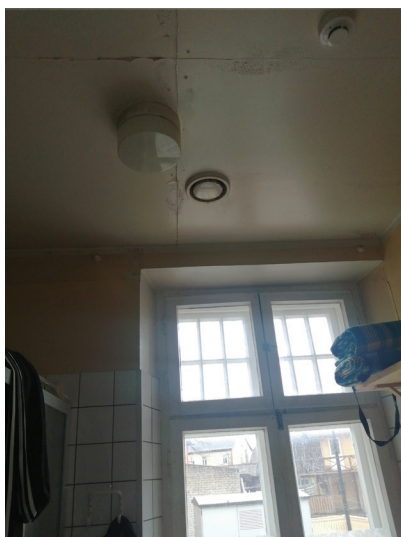
Allatoodud lagi I korruse vannitoas (47)
