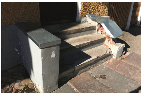
Lisasissepääsu vigastatud trepp (3)
