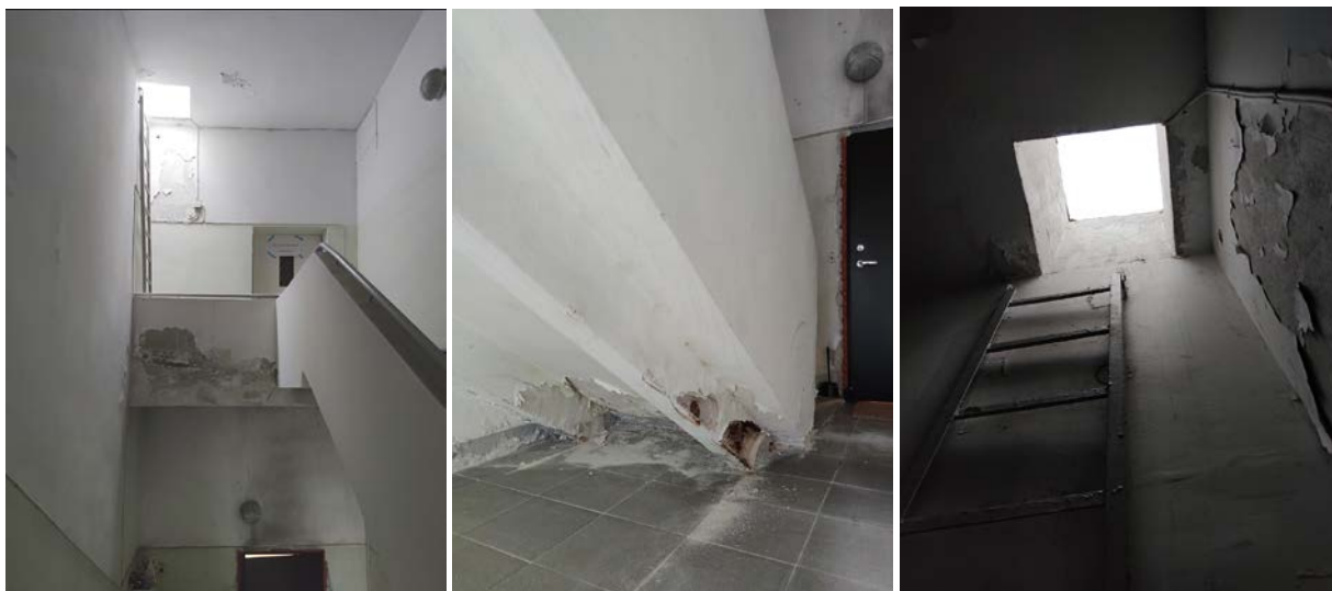
18. Katmata katuseava põhjustatud veekahjustused piirdel, trepil ja seintel.
