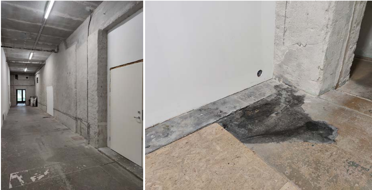
22. Vineerpõrandad, lokaalse põlenguga koht ja pudisev seinakrohv.
