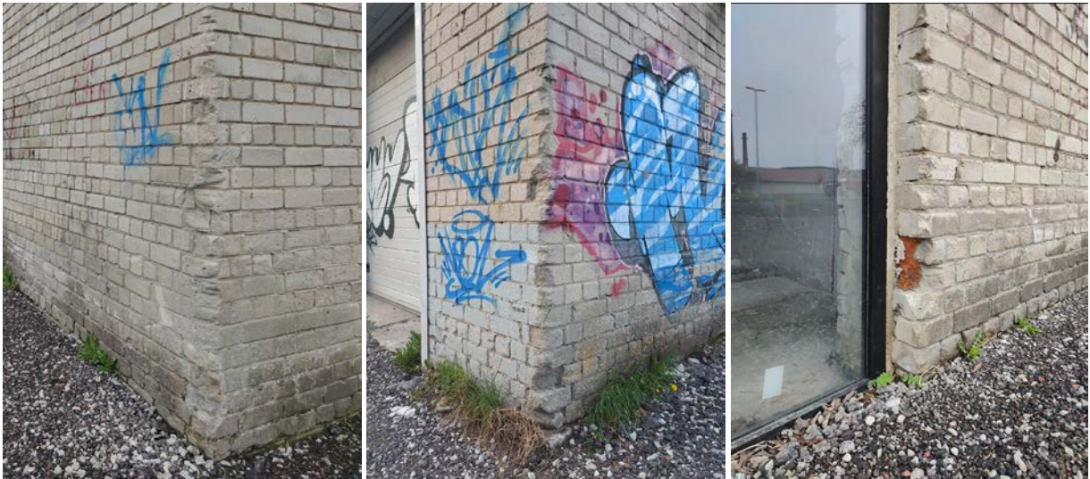
15. Silikaattellise mehaanilised kahjustused hoone välisnurkades ja aknapaledel.
