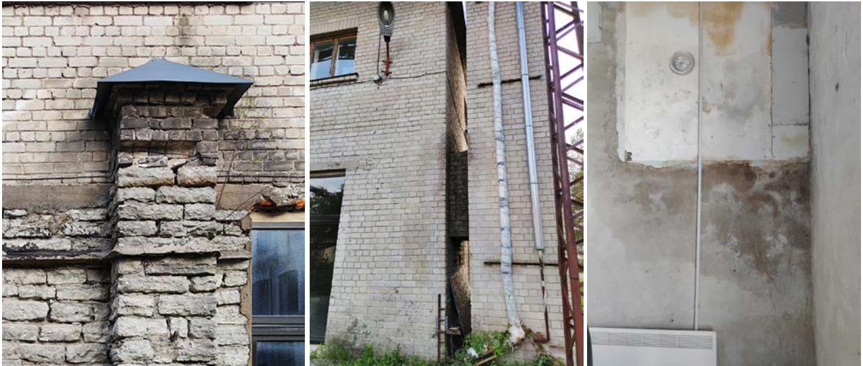
16. Niiskuskahjustused tugipiilari ja ühendusšahti kohas.
