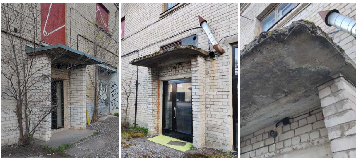
21. Konsoolised betoonvarikatused on servast üsna lagunenu.
