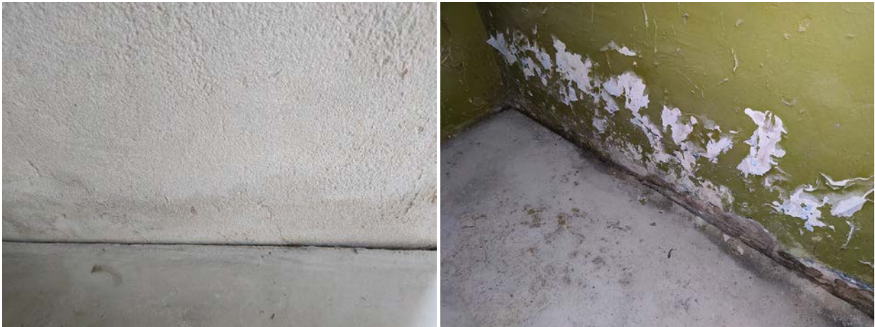
12. Välisseina ja põranda nurgas nähtav sokli niiskusprobleem erinevates ruumides.
