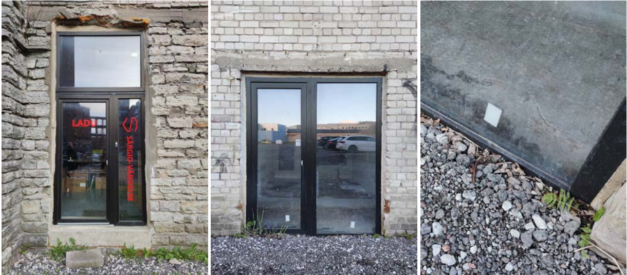
19. Vahetatud aknad ja leke soklisõlmes.
