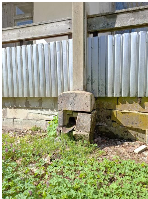
Ill 79. II korpuse sademesüsteem (pilt IV. 2025)
