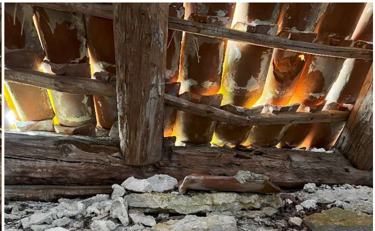
65. Keldri katuseroov. Autori foto 09.04.2025
