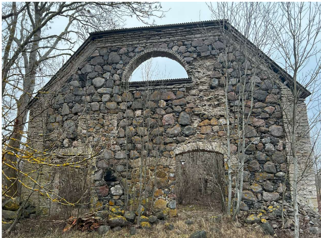
23. müüri kahjustused lõuna fassaadil, autori foto 09.04.2025
