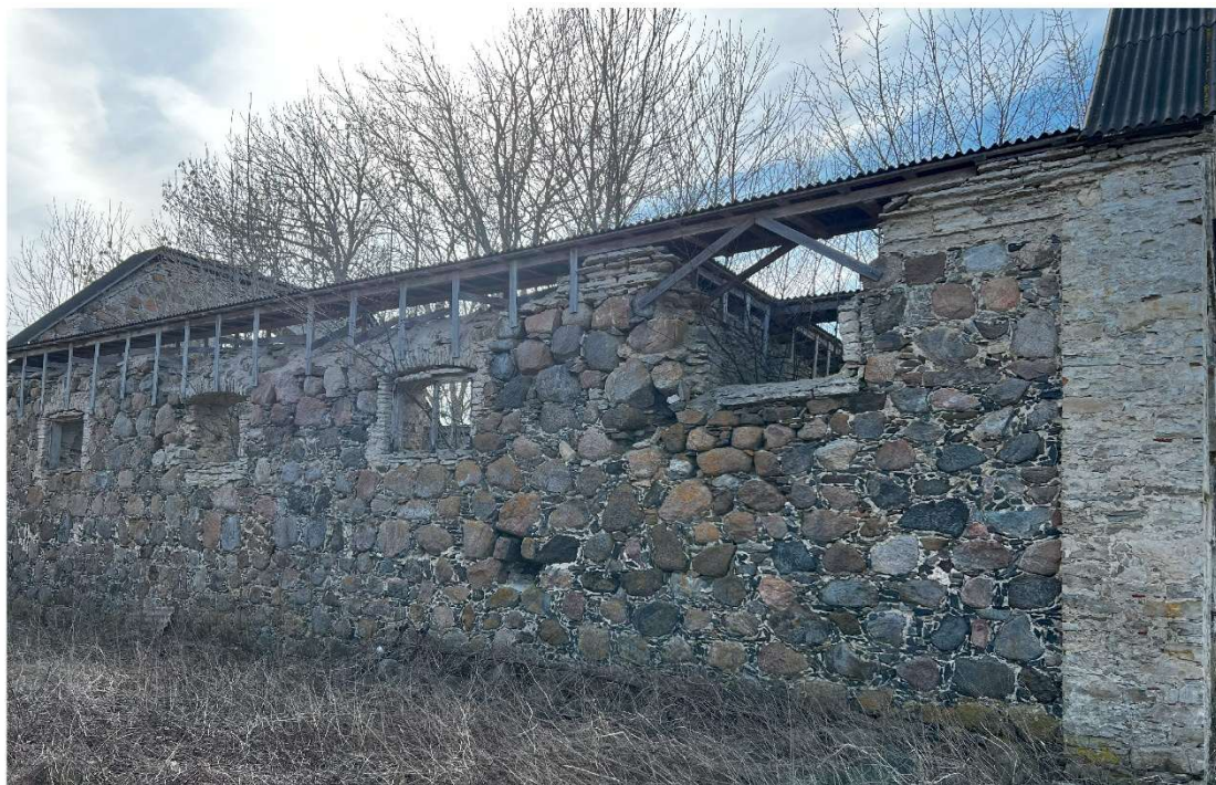
21. Müüri kahjustused ida fassaadil. Autori foto 09.04.2025
