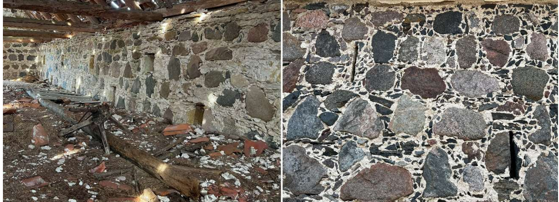
70.Katusekorruse tuulutussavad seest. Autori foto 09.04.2025 71.Katusekorruse tuulutussavad väljast. Autori foto 09.04.2025
