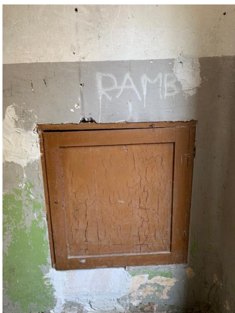
Foto 29. Vana elektrikapp (Allikas: autor)
