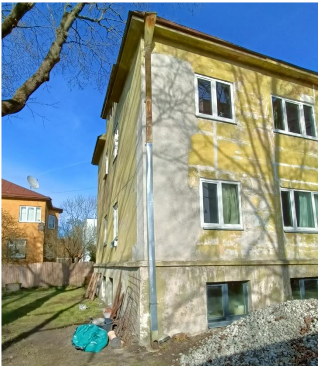
Foto 19. Vihmaveesüsteem osaliselt parandatud uue plekiga (Allikas: autor)
