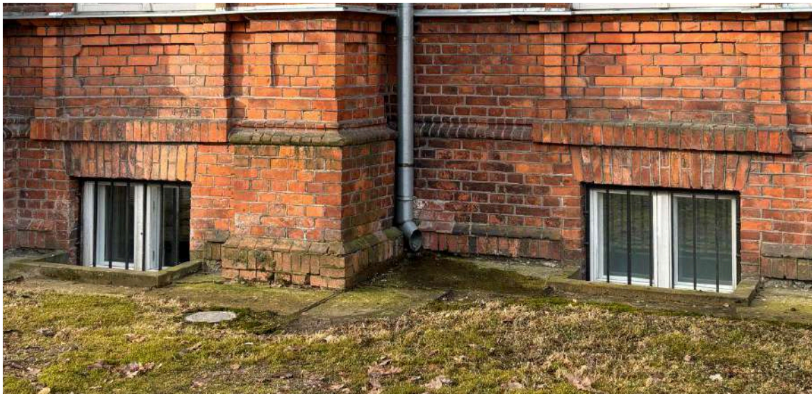
Foto 12. Vee äravoolusüsteem ja soklikorru. Autori foto
