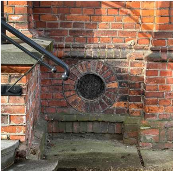
Foto 10. Originaalmahu soklikorru ja vundament. Esineb niiskuskahjustusi. Autori foto
