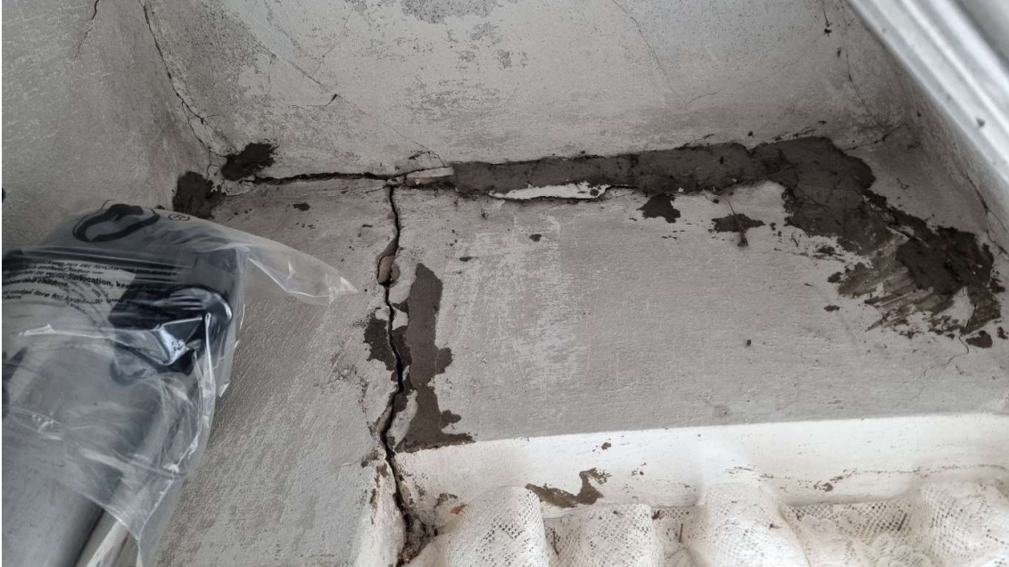
Põhjapoolne müür, mis on irdunud diafragmaseinast (ill 22)
