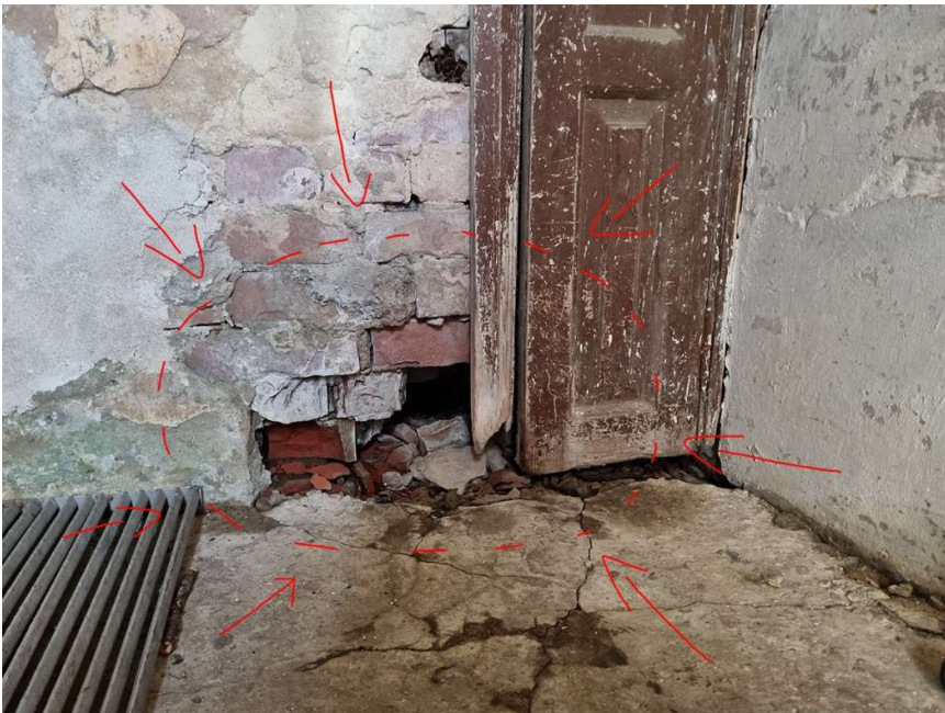
Puudev vundamendiosa, mis on põhjustanud prao diafragmaseinas (ill 21)
