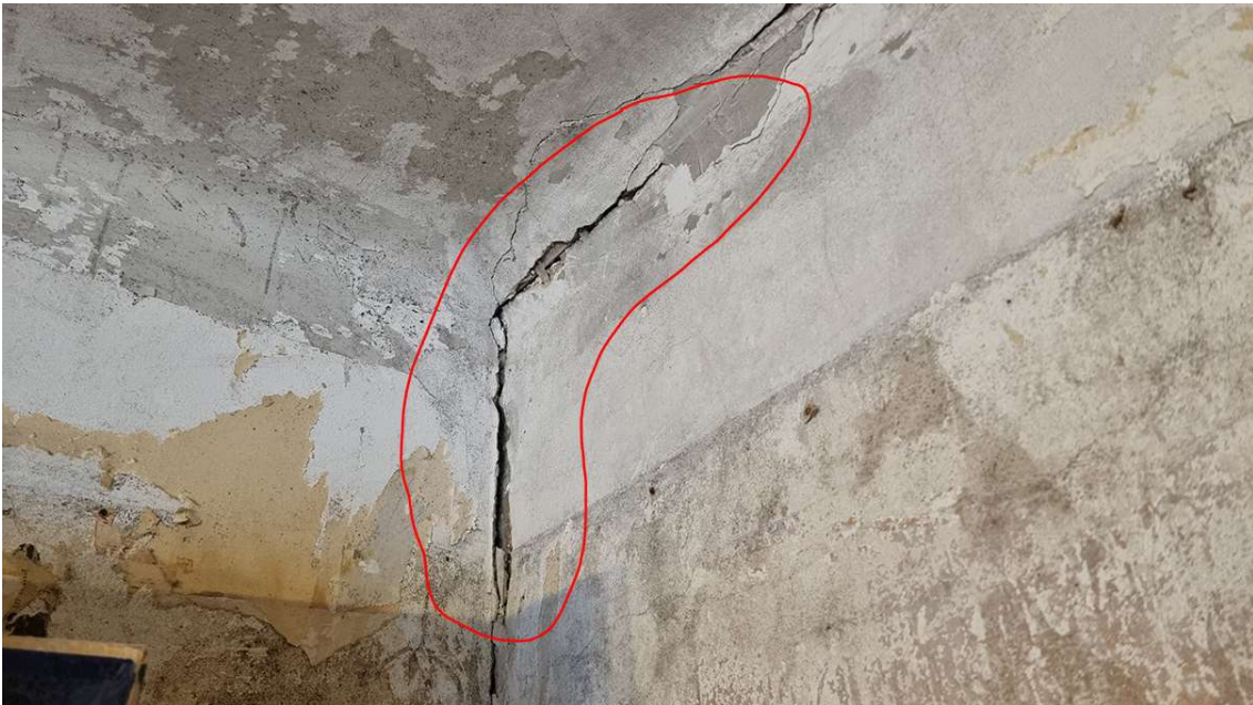
Põhjapoolne müür, mis on irdunud diafragmaseinast (ill 23)
