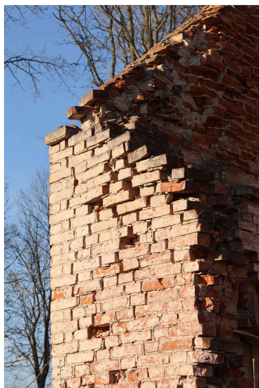
Joonis 45. Külmatsüklite poolt tekitatud kahjustustega katmata müüritis.
