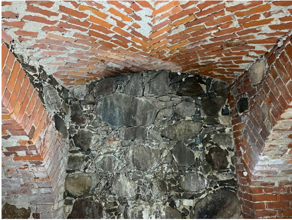
Joonis 36. Niiskus- ja soolakahjustused keldris, käimla all.
