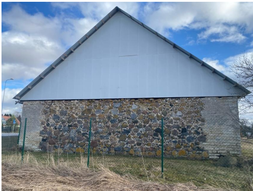
Pilt 8 Loodepoolne maakivist ja paekivist otsasein ning konstruktsioone kaitsev ajutine kergsein ja katus
