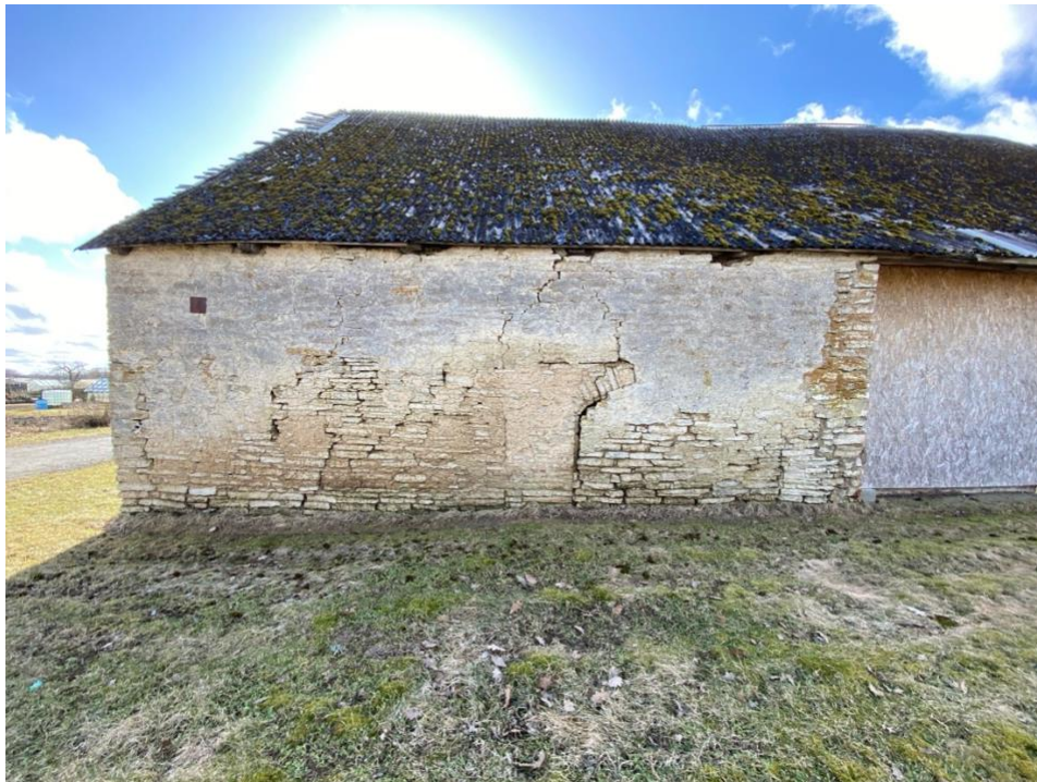
Pilt 23 Hoone kirdepoose külje vasakpoolne nurk kinnimüüritud ukseava ja säilinud lubikrohviga otsevaates
