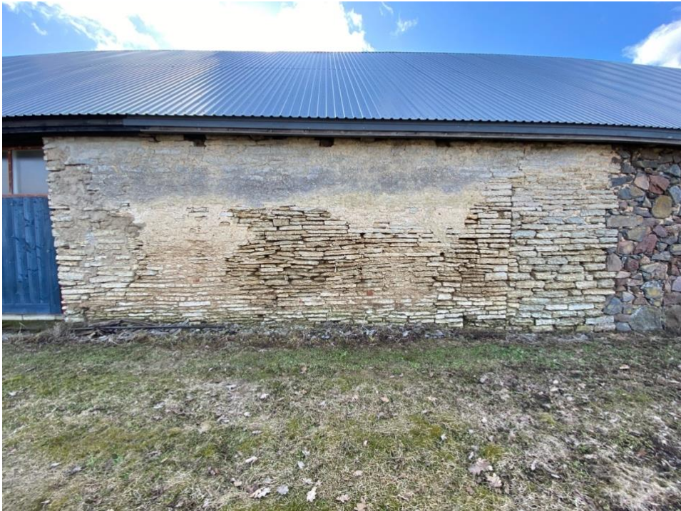
Pilt 27 Hoone kirdepoolse külje keskosas säilinud lubikrohv
