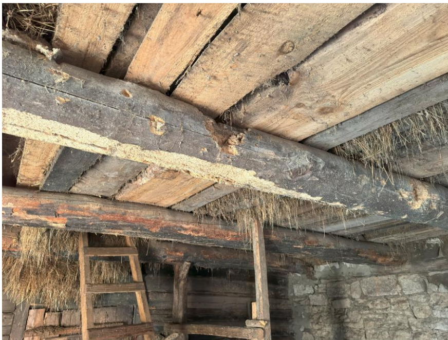
31 Rehala lagi, mardika kahjustused laetaladel. (Autori foto)
