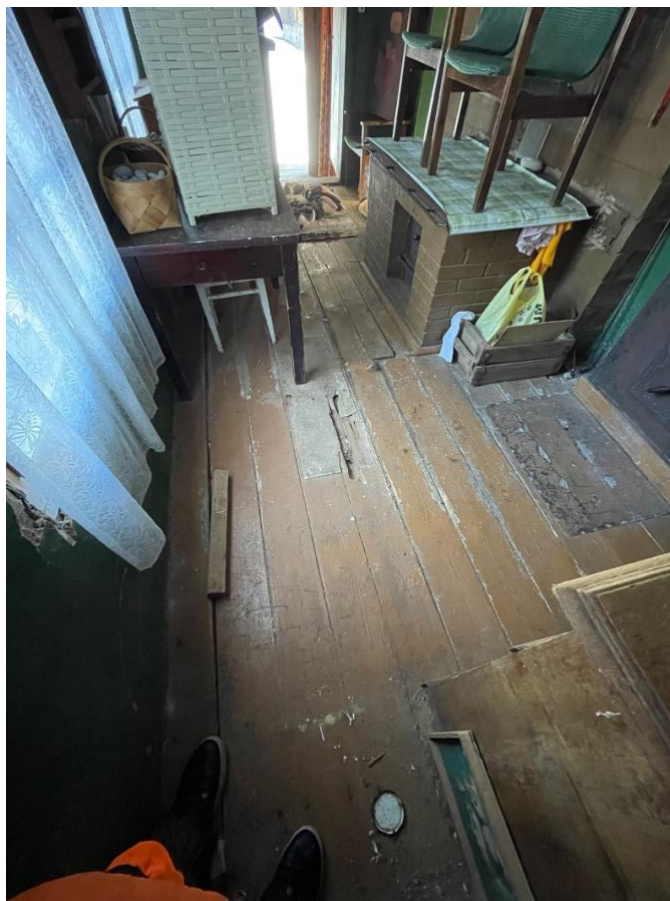
25. Mädanikkahjustusega laudpõrand köögis (Foto: Karmo Tõra 2024)
