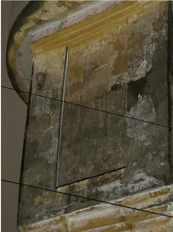
20. Niiskuskahjustused fassaadil (jaanuar 2024)
