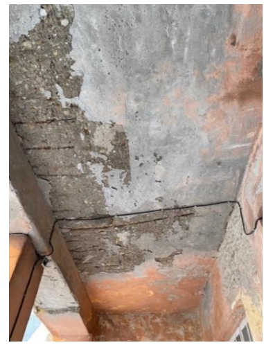
15. Sissepääsu läbivajunud lagi. Autori foto.
