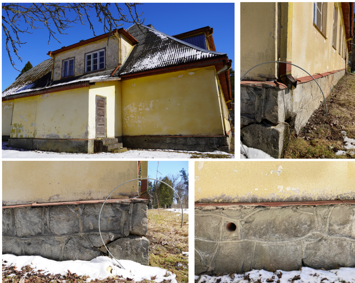
26. Hoone sokkel ja selles tuvastatud kahjustused aprillis 2023. aastal. Fotod: Piia Tammpuu.
