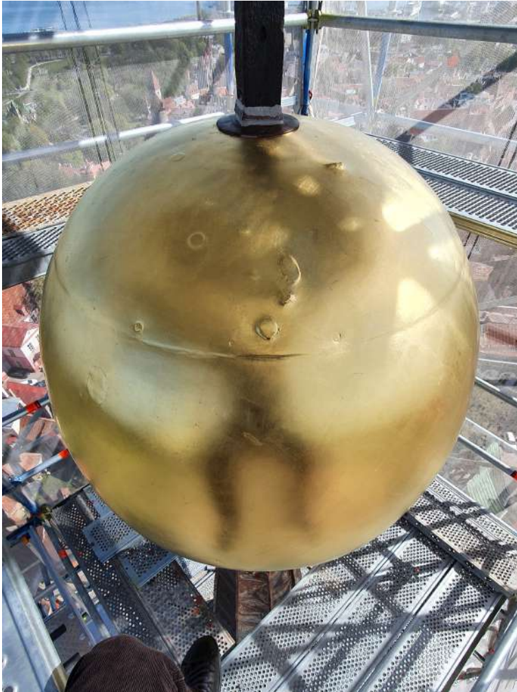
Foto 8 Tipukuul. Näha on nii ülemise kausi liitekoht ja kinnitusneedid kui ka rohked parandatud kuuliaugus. (Bristol, 2022)
