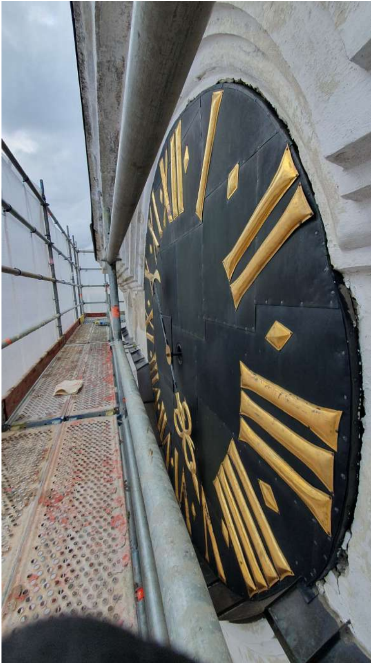
Foto 20 Lõunakülje ajanäitaja enne 2023. aasta korrastustööde algust. Pildil näha värvist kooruv osuti latt ja kullatise kahjustused. (Bristol, 2023)
