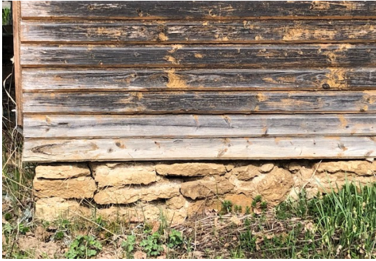
Ill. 23. Vundamendi kahjustused 1. Foto V. Allorg 2023.
