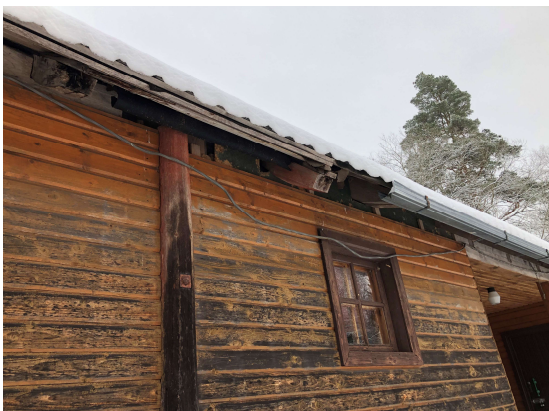
Ill. 31. Esifassaadi katusekarniis on kahjustunud. Foto V. Allorg 2023.
