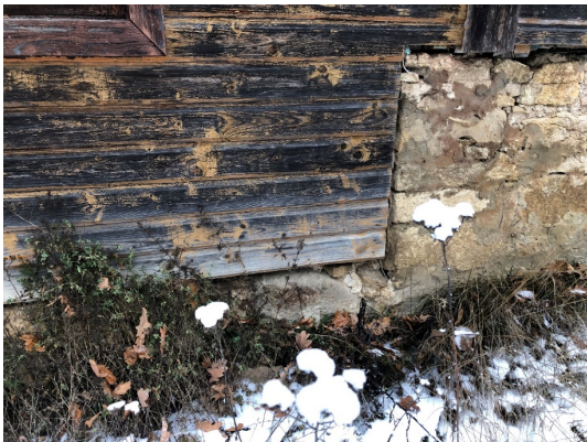
Ill. 25. Vundamendi kahjustused 3. Foto V. Allorg 2023.
