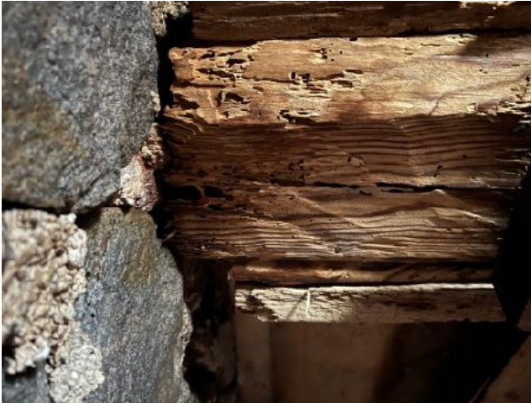
Foto 8. Põrandatalade kahjustus keldris
