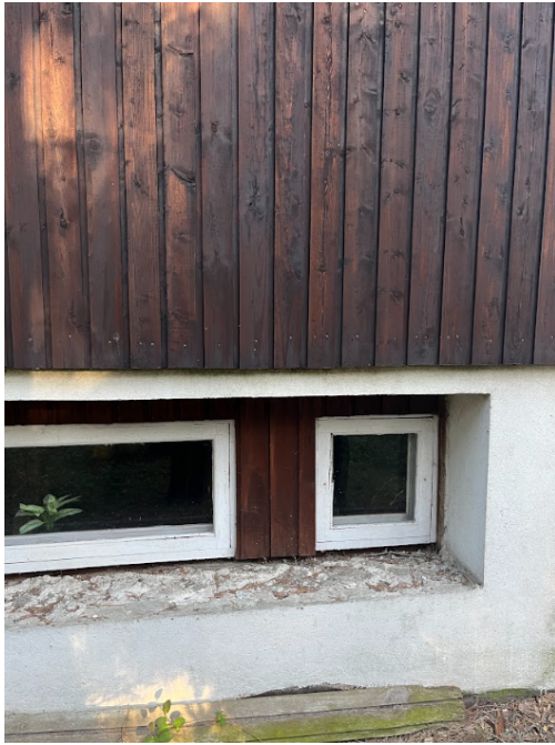
Il 32. Idafassaadi alumine aken. Puudub aknaplekk või veelaud. (pole kunagi ehitatud)
