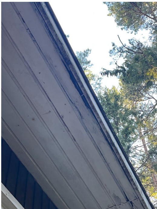
Il 19. Veekahjustus räästal põhjafassaadil
