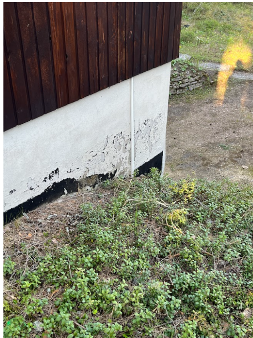
Il 20. Sokli kuluv värv, nähtav niiskusesoltasioon. Bituumen
