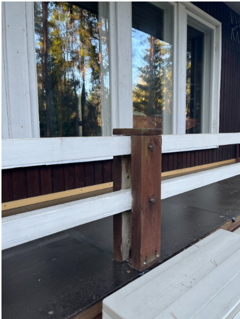
Il 29. Rõdu piirdepost. Needitud ühendused.
