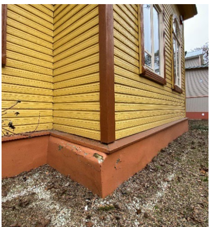
Joonis 16. Veelaud ei kata vundamenti. Soklilt krohv pudeneb maha. Foto: Katerina Laansoo, 2023
