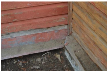
III 24. Kahe erineva fassaadilaudise profiil. Vasakul algupärane laiem profiil. Lisaks on näha veekahjustuste mõju sokli veelaual ja fassaadidel.
