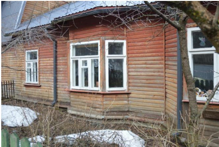
III 26. Fotol on näha, et puudub projektis ettenähtud püstlaudis esimesel korrusel.
