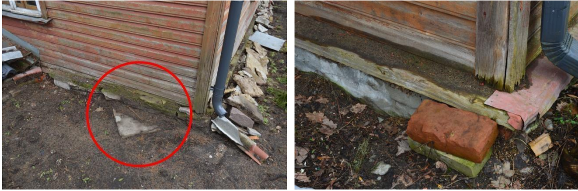
Ill 19. Krohvitud vundament. Puidust sokli veelaud (osaliselt kaetud plekiga). Vasakul on näha likvideeritud sissepääsu astmeplaati.
