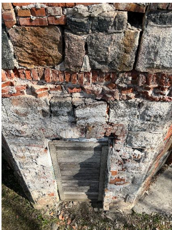
Foto nr. 9 lammutusest kahjustunud fassaad
