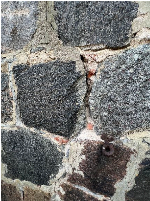
Foto nr. 11 lagundenud vuugid fassaadil
