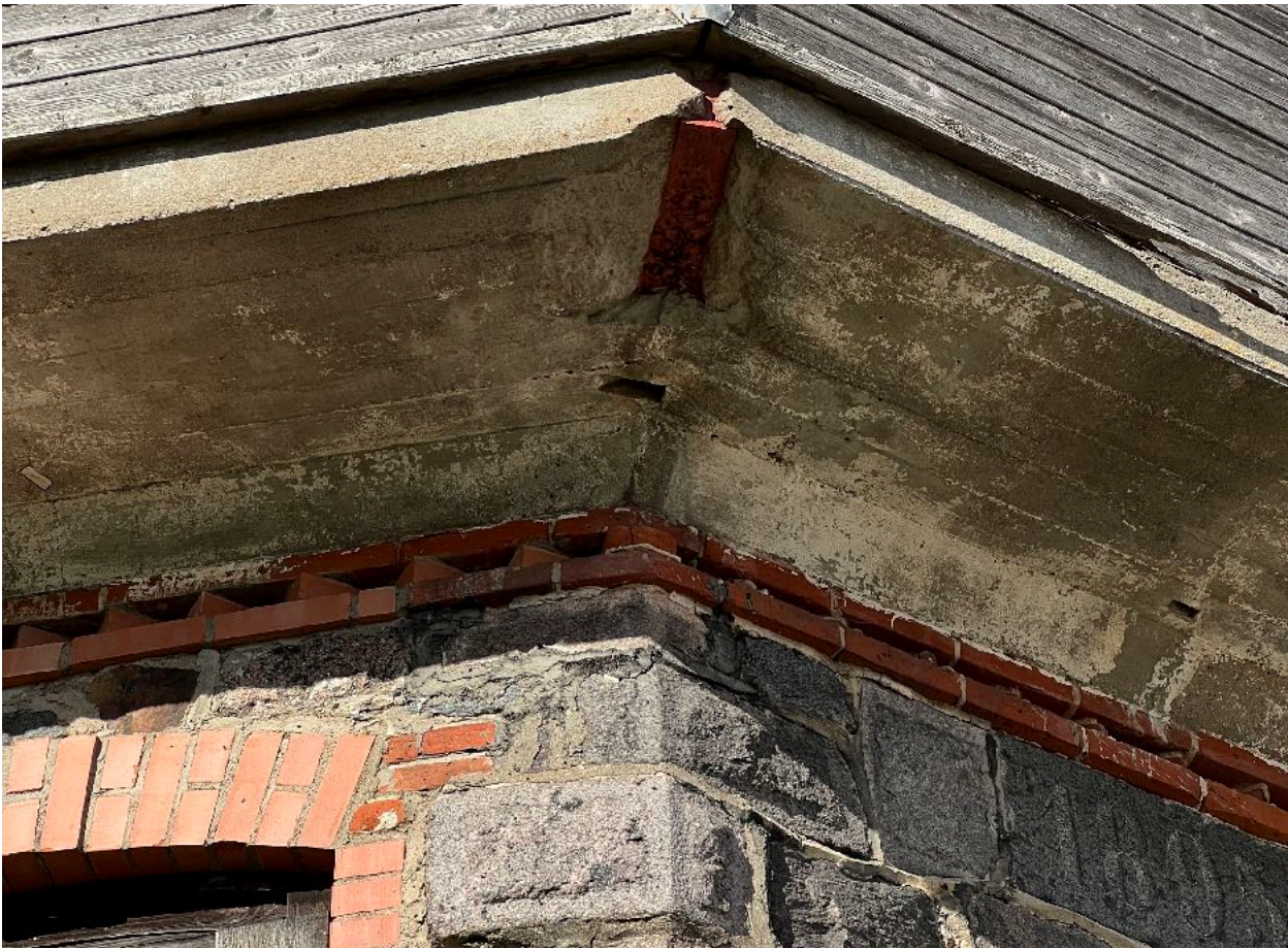
Foto nr. 25 kolmanda korruse betoonist paljandunud metalltala. All paremas nurgas dateeritud müürikivi "1895"
