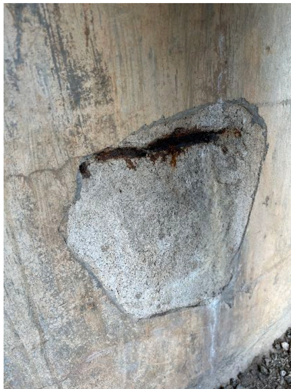
Foto nr. 32 veepaagi välimisest küljes lagunenud betoon
