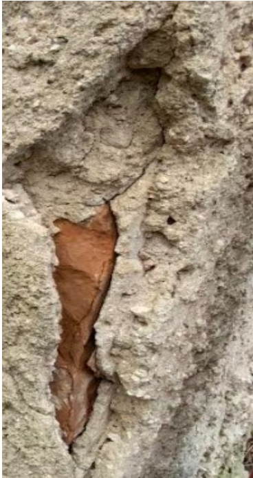
26. Lubikrohv välisseinas. Allikas: autori foto
