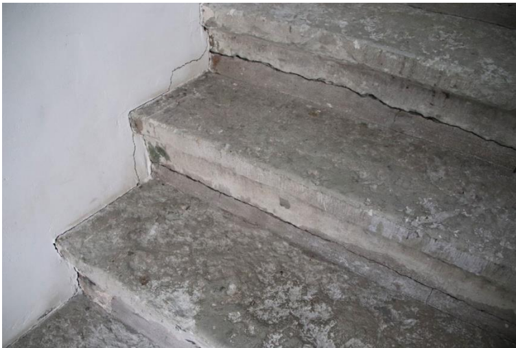
15 Trepiastmed on värvi- ja krohvipritsmetega määrdunud. Vertikaalsed vuugid teise ja kolmanda korruse trepimarssidel osaliselt lagunened.
