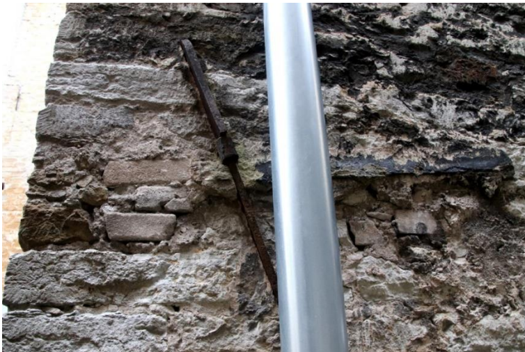
34 Müüriankur hoone lõunafassaadil.
