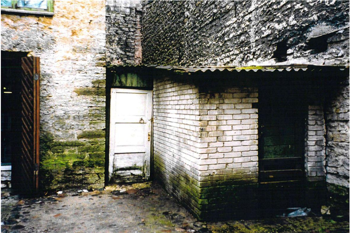
L25 Vaade hoovi lõpust Mürivahe tänava poole, 2001 Vasakul paistab hoone F, paremal Mürivahe 31 hoone B müür ja taga Mürivahe 31 hoone A müür, keskel lammutatud kuur.
