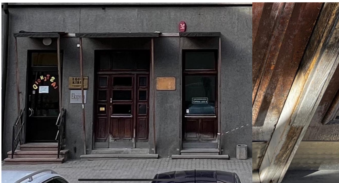
Hoone Promenaadi tänava poolne paraaduks. Parempoolsel fotol näha, et ukse impost on hilisem ja tehtud sõrmjätkega jätkatud liimpuidust 58
