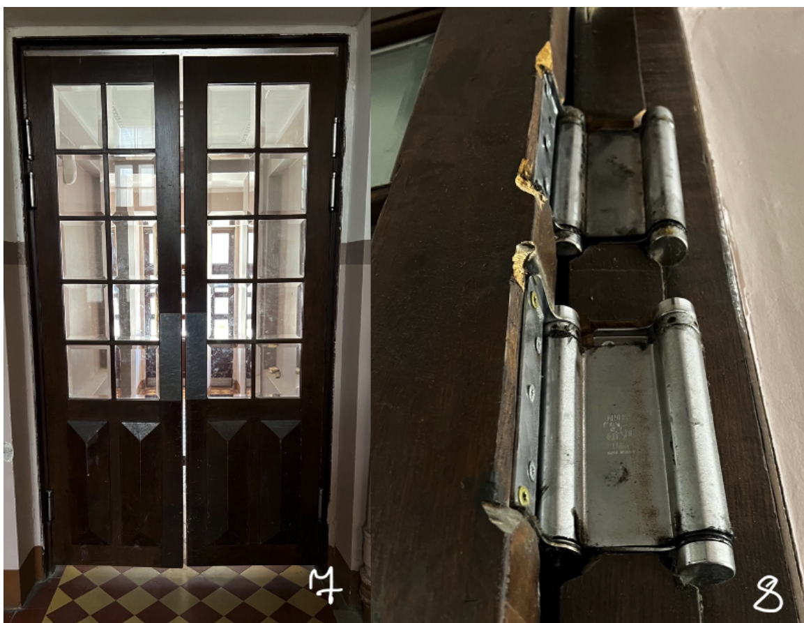
Pendelüksed peasissepääsu tuulekoja ja koridori vahel. Parempoolsel pildil on näha märke ukse hingede vahetamisest 61
