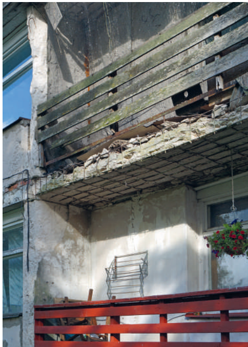
4.27: Enamik silikaltsiidist renoveerimata tüüpkorterelamud näevad tänu laiguti kooruvale krohvile pisut õnnetud välja. Ekstreemsematel juhtudel on aga konstruktsioonid lausa avariilised. Due to patchy crumbling render most un-renovated standard design apartment buildings look quite wretched. In extreme cases the construction is outright dangerous.
